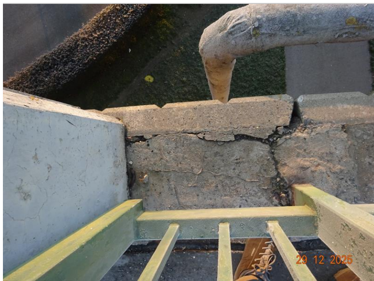
45_podrceny beton rimsy.JPG
