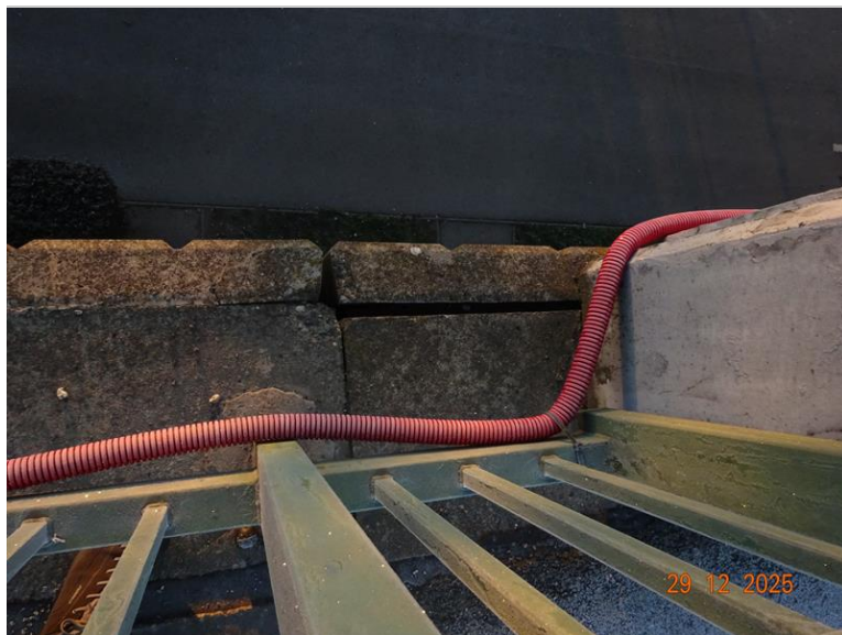
44_odchlipnutí prefabrikátu od monolitické části.JPG
