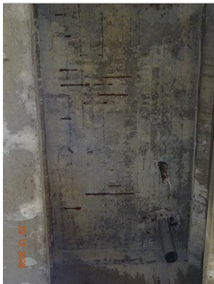
27_koroze vyztuze v pohledu.JPG
