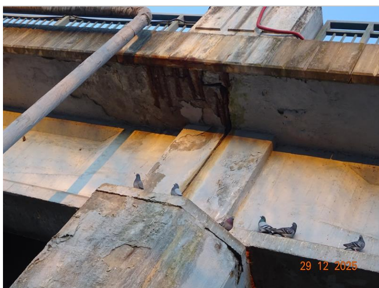
26_zatekani na podhled nad P3.JPG
