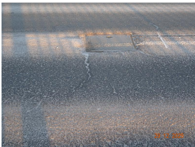
31_poruchy vozovky v niste sachtu.JPG
