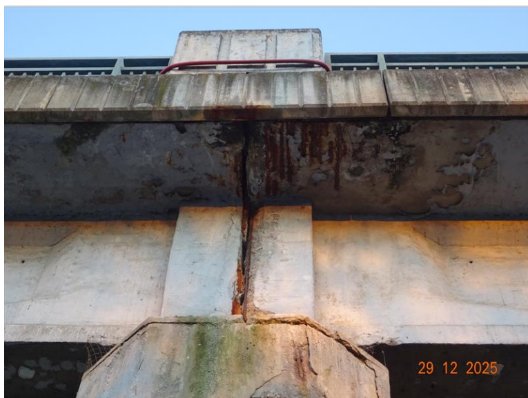
25_zatekani do podhledu NK nad P2.JPG
