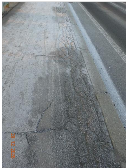
35_rozpad praveho chodniku.JPG
