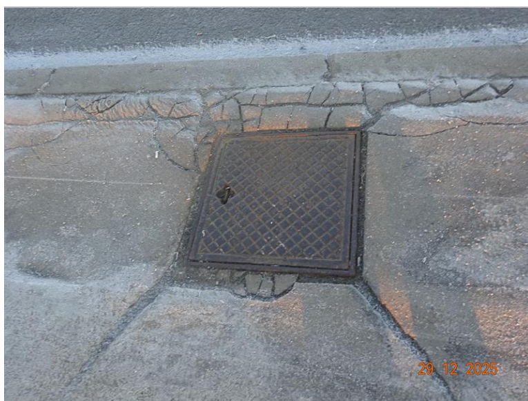
37_porucha chodniku v miste sachtu.JPG
