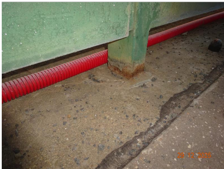
60_koroze sloupku zabradli.JPG
