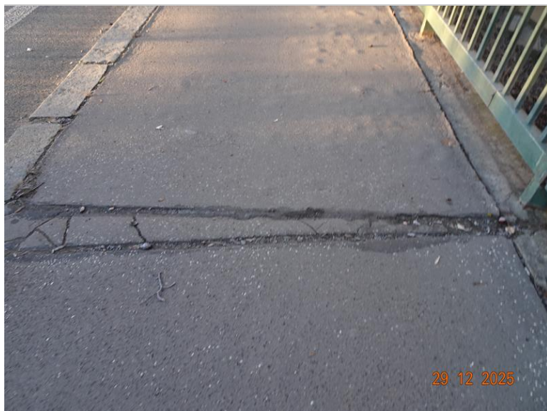
42_trhliny v chodniku.JPG
