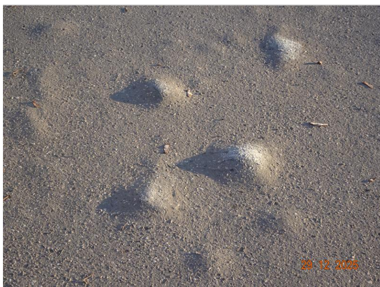
44_nerovnosti v krytu chodniku.JPG
