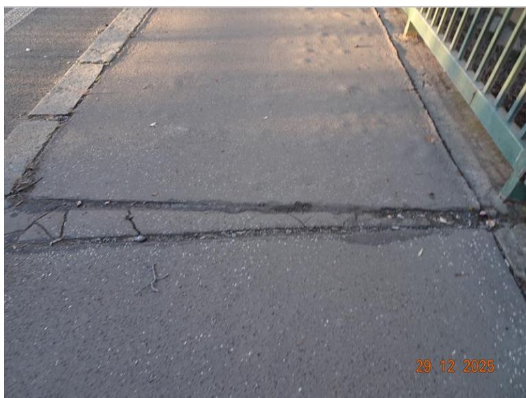
42_trhliny v chodniku.JPG
