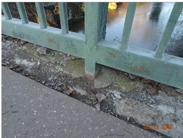
41a_degradace betonu rimsy.JPG
