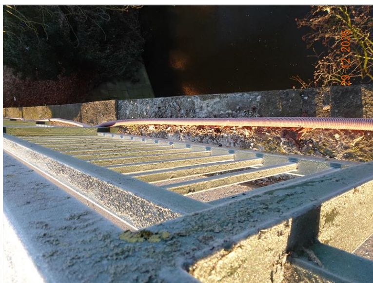
41b_degradace betonu rimsy.JPG
