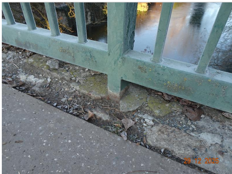
41a_degradace betonu rimsy.JPG
