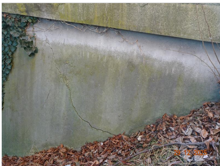
11_trhlina na PKŘO2.JPG
