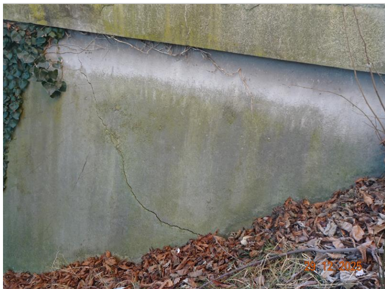
11_trhlina na PKŘO2.JPG
