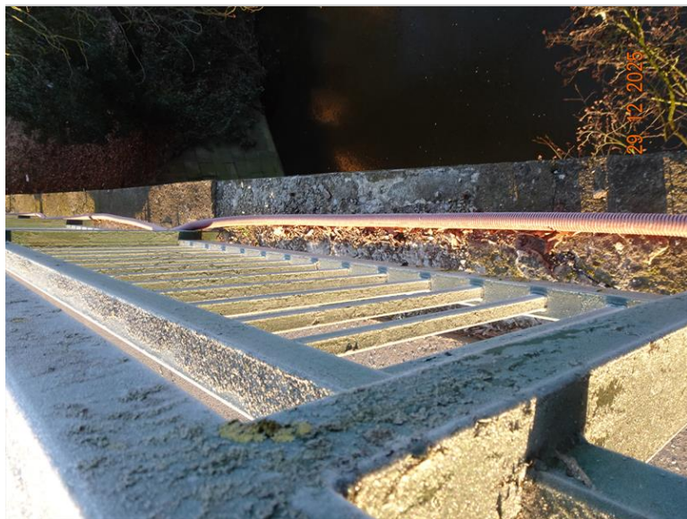
41b_degradace betonu rimsy.JPG
