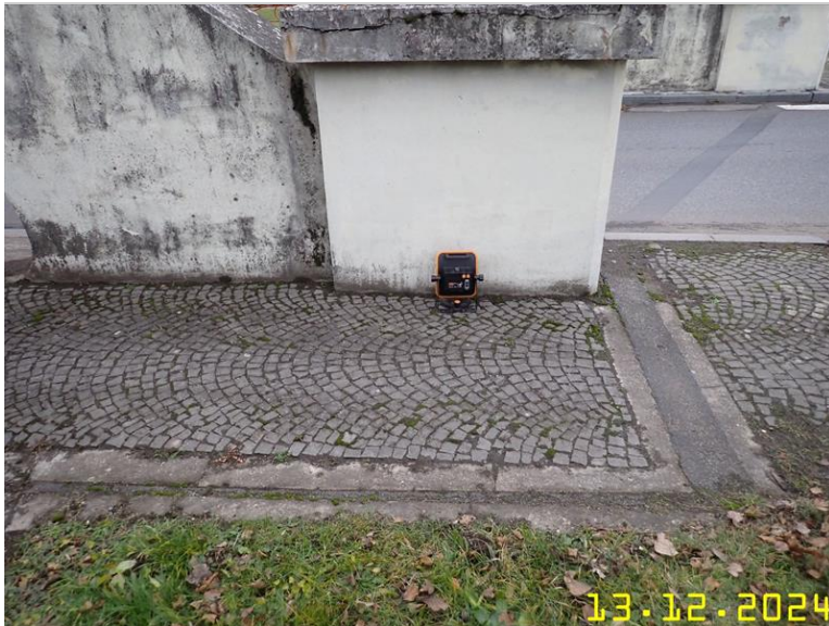
022 DILATACE NA PRAVÉ STRANĚ U OPĚRY O2.JPG
