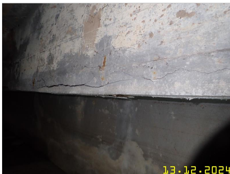
086 TRHLINY NA PŘÍČNÍKU.JPG
