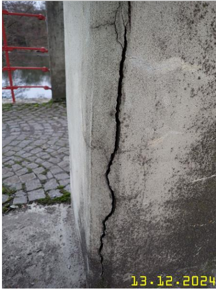
033 TRHLINY V ZÁVĚSECH.JPG
