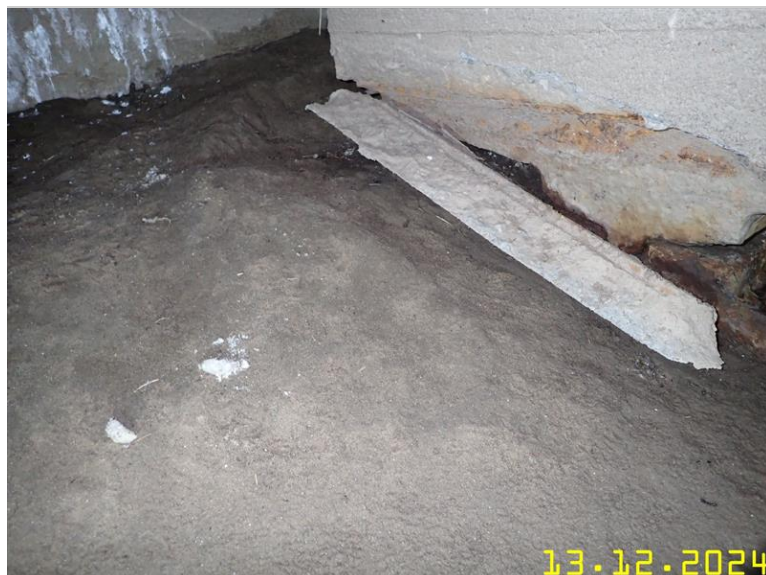
085 STOJKA ODPADÁVAJÍCÍ KRYCÍ VRSTVA.JPG
