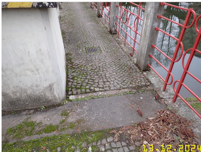
004 CHODNÍK NA PRAVÉ STRANĚ MOSTU DILATACE.JPG
