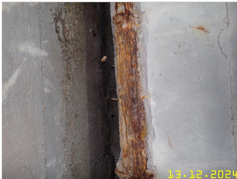
090 KOROZE NA O1 PŘÍČNÍKU.JPG
