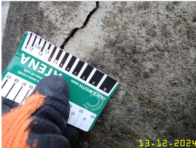
012 TRHLINY VE ZÁVĚSECH.JPG
