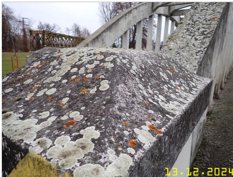
006 POVRCH PRAVÉHO OBLOKU.JPG
