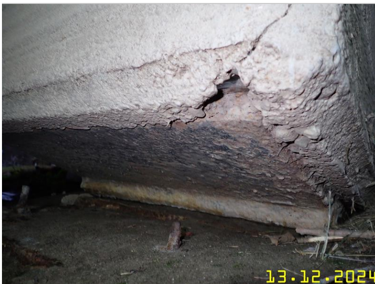
083 KOROZE KLOUBŮ NA 01.JPG
