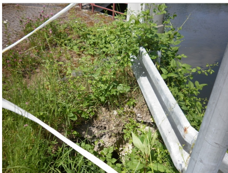
Propadlý terén za levým křídlem OP2
