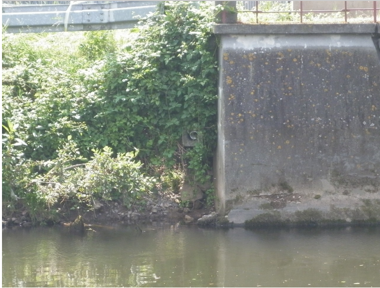
Pohled na levé křídlo OP2 - skrz vegetaci prosvítá osvětlené dno jámy těsně nad hladinou po propadnutí terénu vedle křídla
