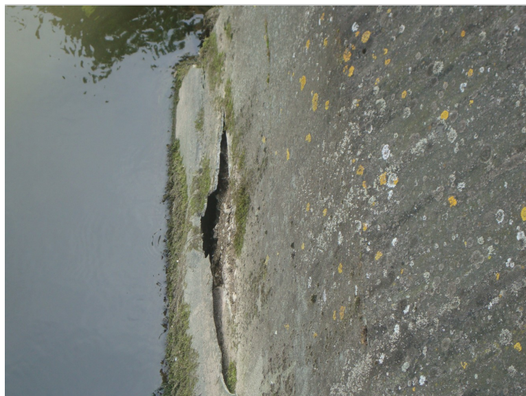
Levé křídlo OP2 - odtržený beton v ploše nad úrovní hladiny
