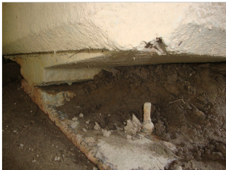
Zanesený levý kyvný blok na OP1
