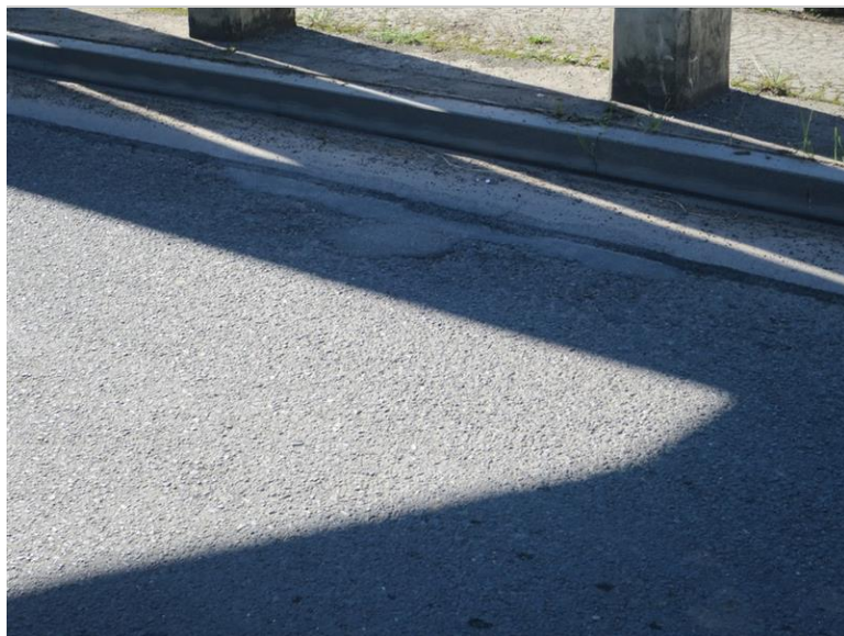
deformace krytu vozovky
