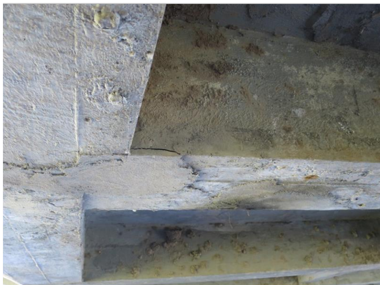
poruchy sanace na spodním líci NK v místě styku mezilehlého příčniku s táhlem
