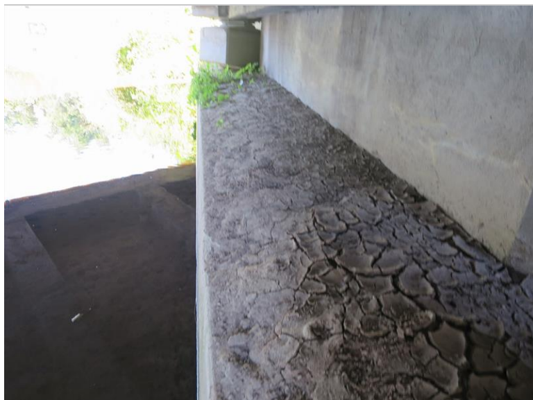
úložný práh na O1
