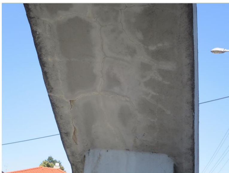
DTTO - již výrazné trhliny na spodní lici pasu s drobnými výluky pojiva
