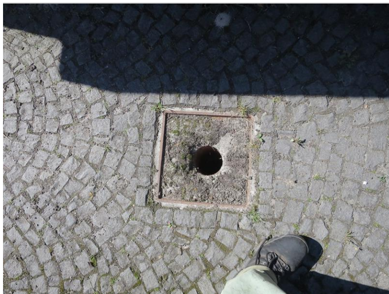
chybějící kryt odvodňovače v prostoru chodníku
