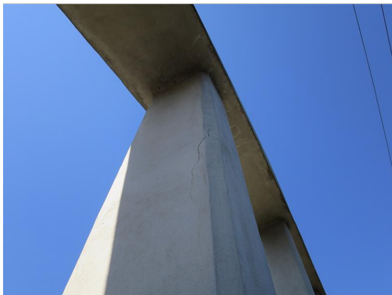
trhliny v sanaci u závěsu
