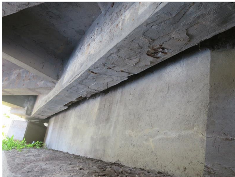
DTTO - poruchy na spodním líci příčniku
