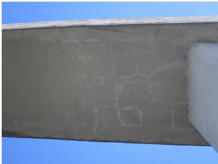
začínající trhliny na spodní lici obloukového pasu
