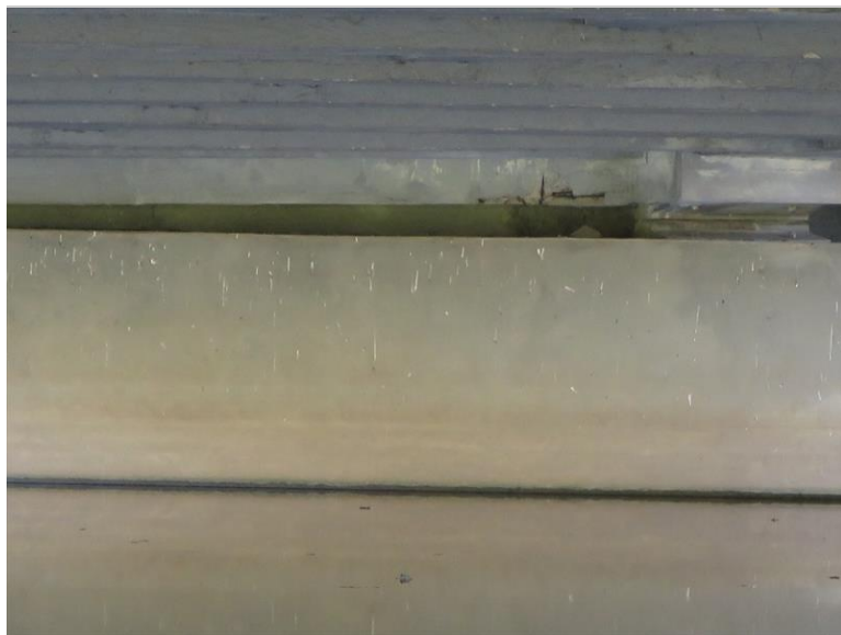
poruchy sanace na boku podporového příčnicku nad O2
